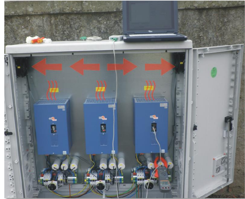
Abbildung 2 Entwärmung dreier ZDM-N über seitliche Lüftungsgitter
